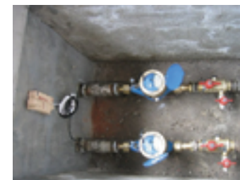
Dobro vzdrževan vodomerni jašek / Pozzetto del contatore debitamente curato (Foto: RVK)
